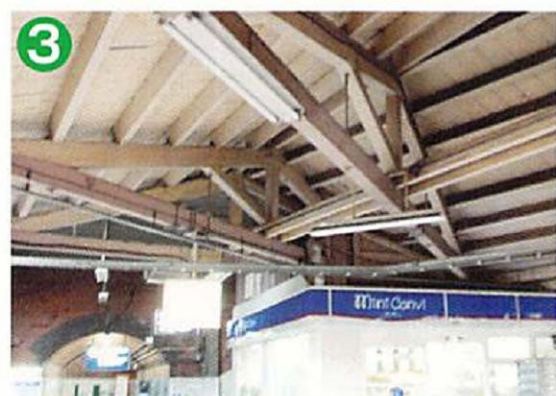
3 1階ホームのトラス組み 取壊し予定 筑豊本線と鹿児島本線が斜めに交差しているため複雑な構造。
